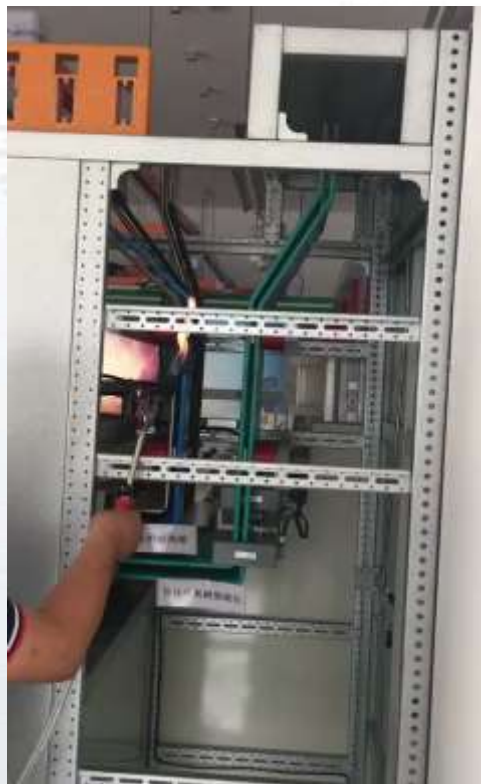
配電盤火焰測試
